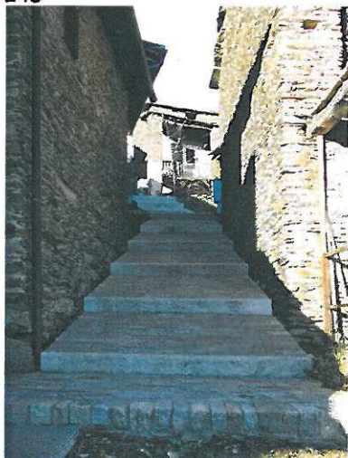
248 percorso esterno sistemato con rampa in pietra: da notare lo stacco dalle murature laterali sistemato a canaletta per il deflusso dell'acqua
